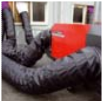
Gaine de recirculation.
